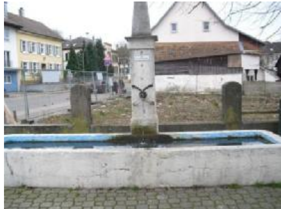
Foto 10: Eingang Gartenstraße - sanierungsbedürftiger Brunnen
